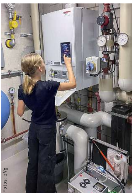
Nevia bei der Kontrolle einer Wärmetechnischen Anlage.
