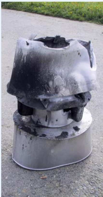
Kaminhut nach Kaminbrand
