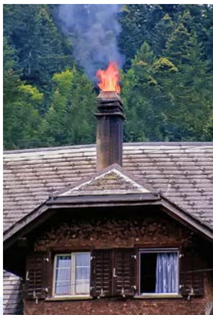
Kamin mit Rauchfahne Cheminée avec des traînées de fumée
