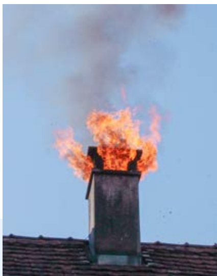
Kamin mit Rauchfahne Cheminée avec des traînées de fumée
